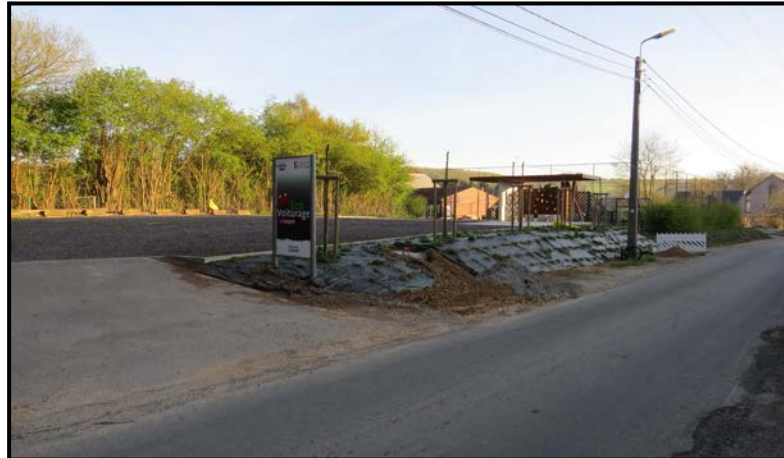
Commune de Wanze - Site de Longpré - Parking d'EcoVoiturage Parking supérieur, panneau d'accueil, plantations et abri voyageurs, point de raccordement pour une future borne électrique
