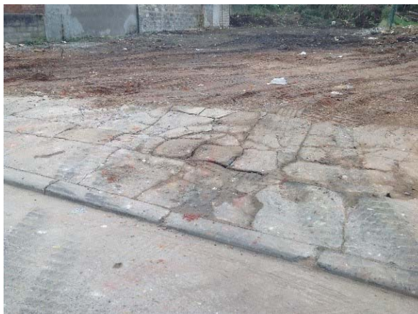
Dégradations de la voirie
