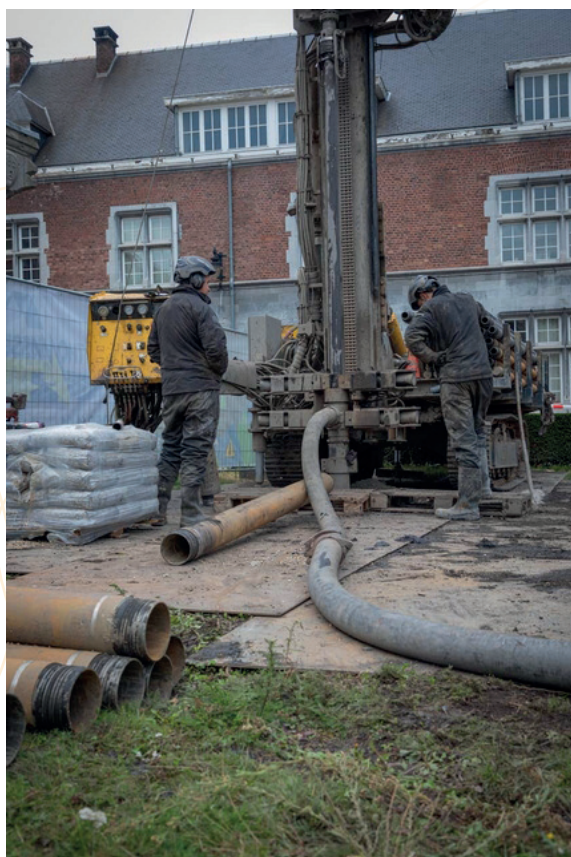
Saint-Laurent – Pompe à chaleur – Géothermie
