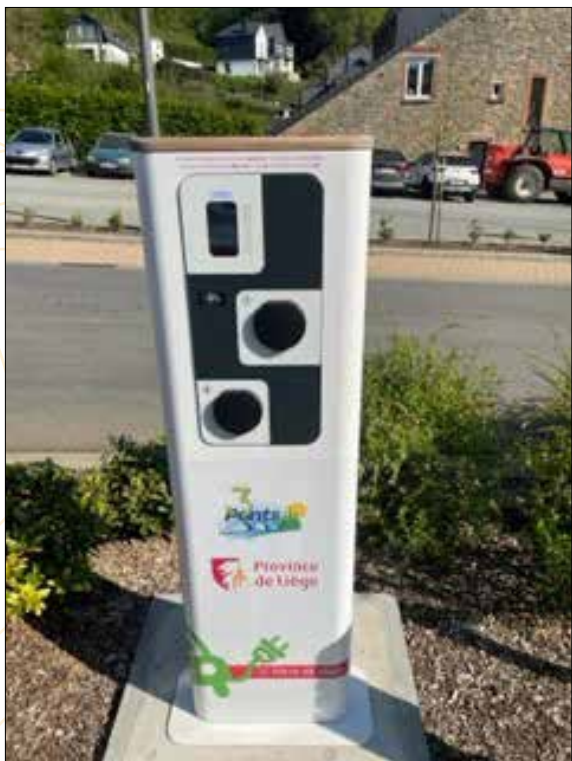
Borne de rechargement provinciale
