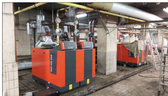
Un exemple de chaudières remplacées
